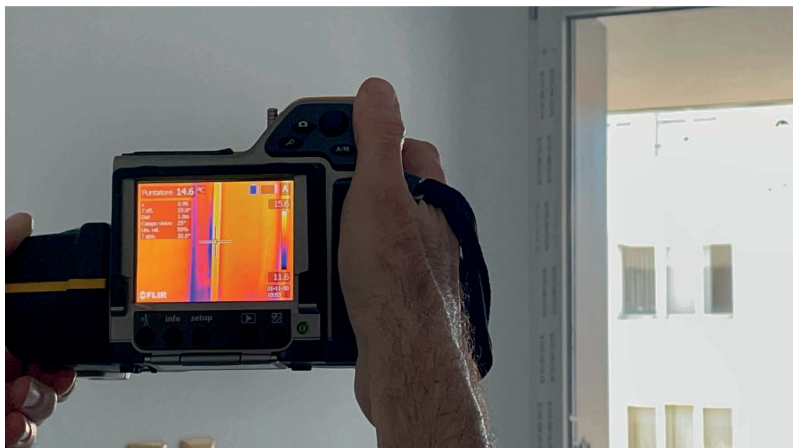
Figura 4 – Indagine con termocamera svolta durante Blower Door Test. Tale verifica evidenzia la differenza di temperatura tra la parete e il giunto primario, dovuta a criticità legate a discontinuità termica e infiltrazioni d'aria. Foto degli autori
