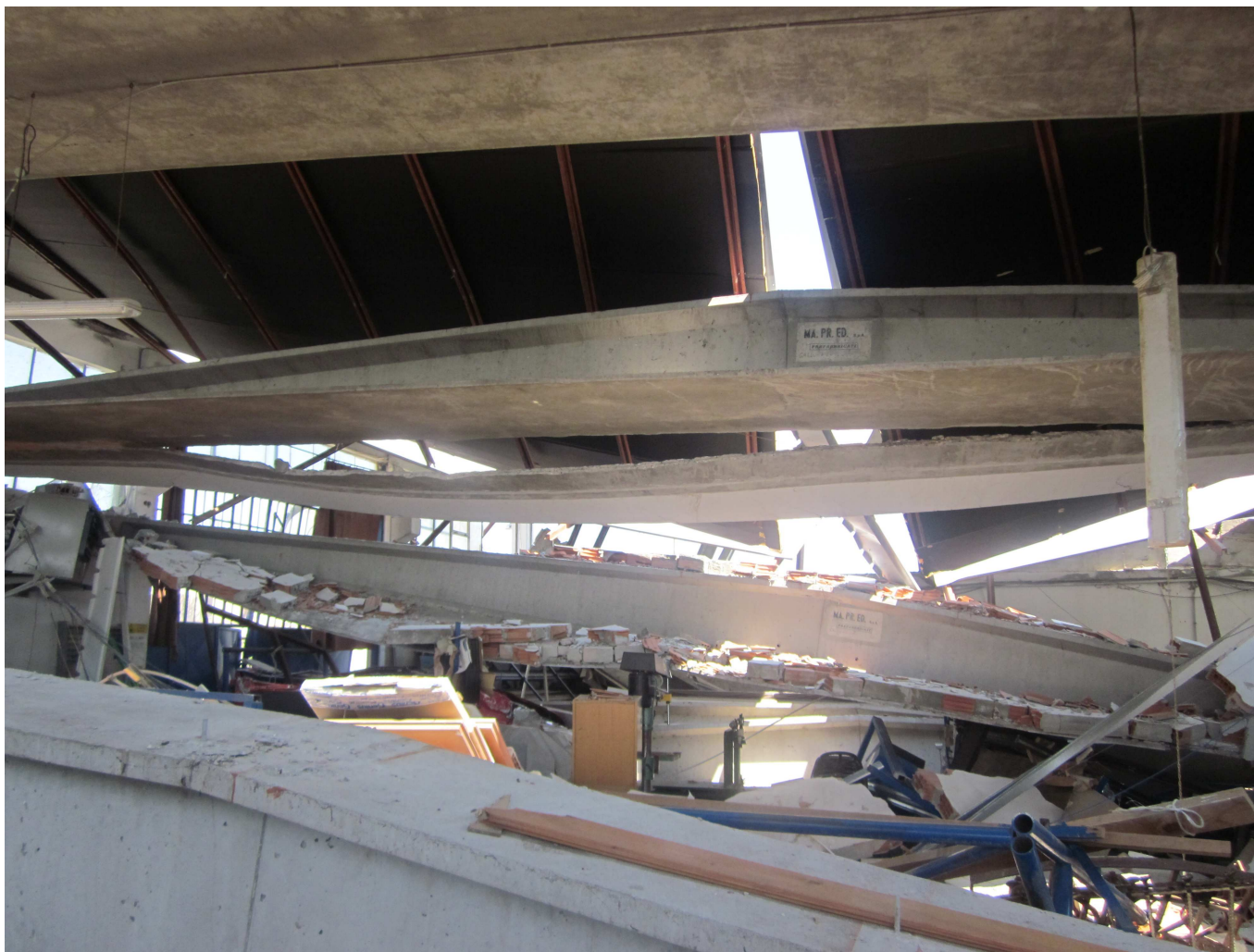
Crollo di tegolo ad intradosso piano per mancanza di collegamento (Ferrara 2012 - Foto Autore)
