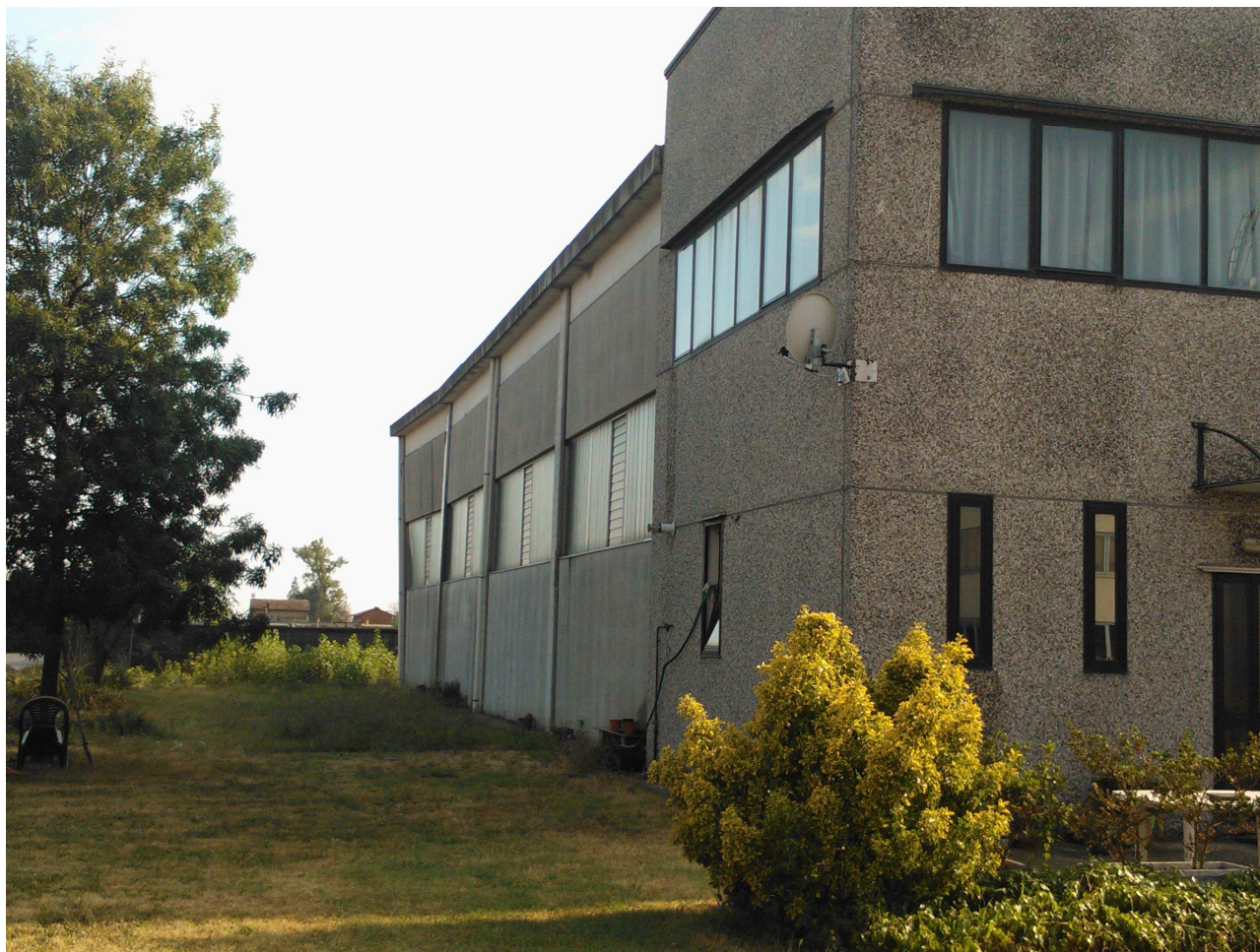
Disallineamenti della facciata: probabili rotazioni pilastri alla base (Ferrara 2012 Foto Autore)
