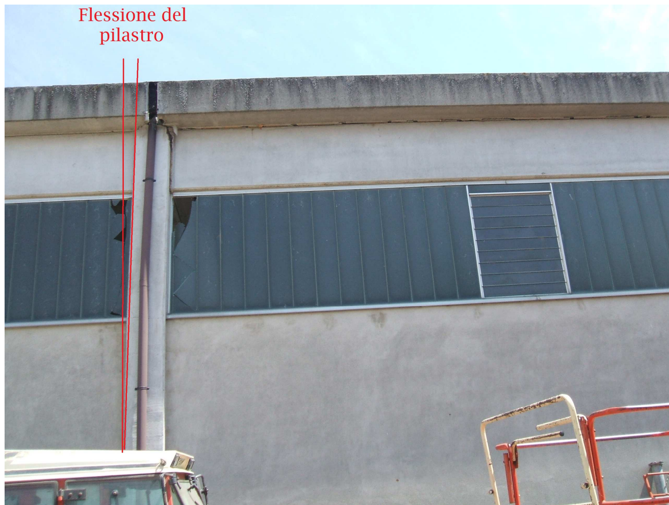
Rottura di un tratto di pilastro (Ferrara 2012 - Foto Autore)
