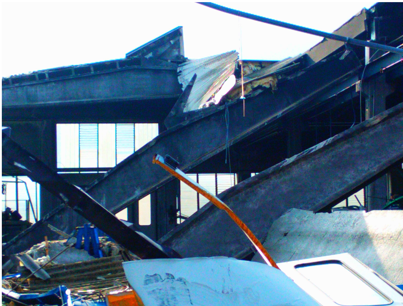
Perdita appoggio delle travi DP (Ferrara 2012 - Foto Autore)
