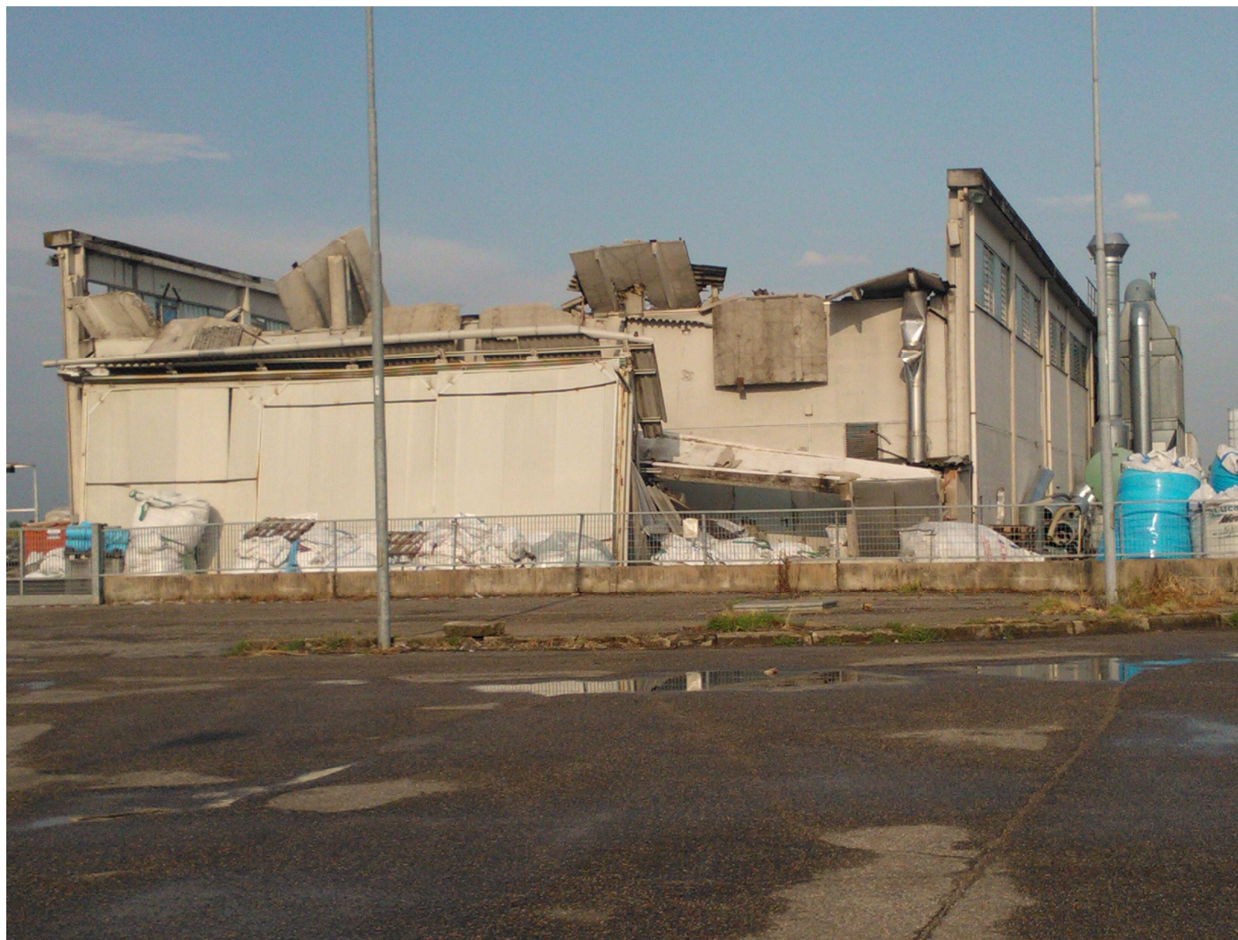
Ribaltamento trave portante (Ferrara 2012 Foto Autore)
